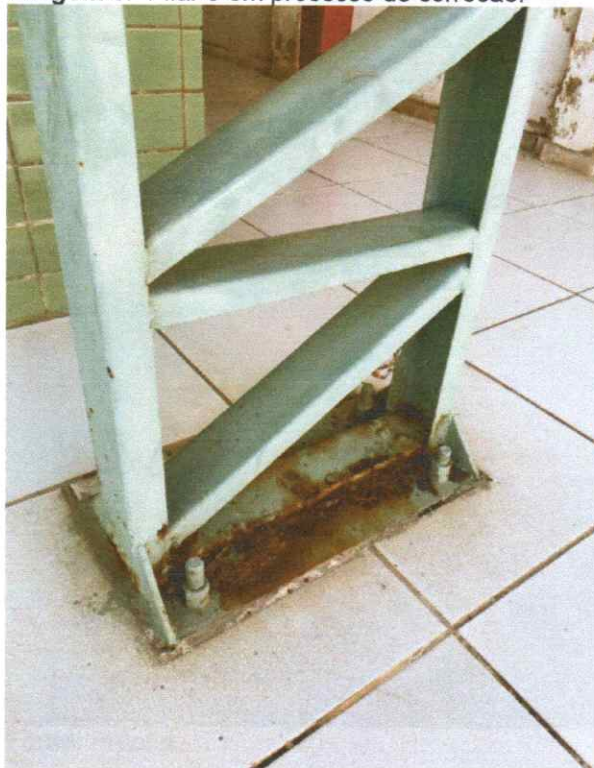
Imagem 8: Pilar 6 em processo de corrosão.
