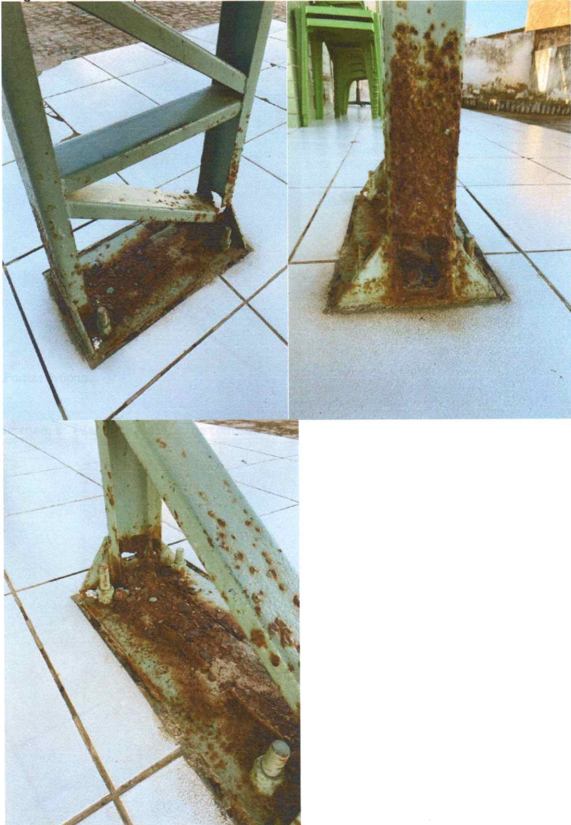
Imagem 3: Pilar 1 em processo de corrosão.
