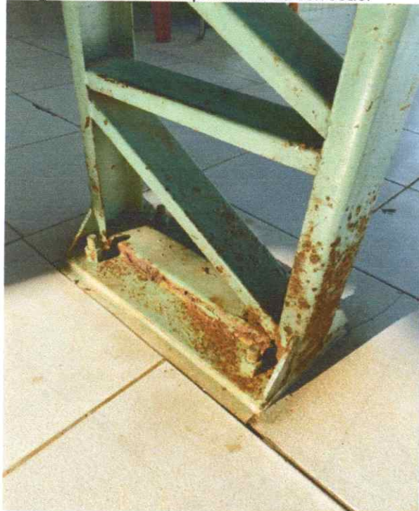
Imagem 4: Pilar 2 em processo de corrosão.
