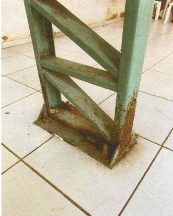
Imagem 6: Pilar 4 em processo de corrosão.
