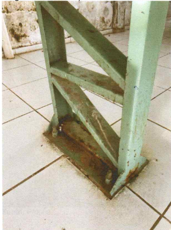
Imagem 7: Pilar 5 em processo de corrosão.
