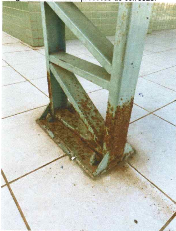
Imagem 5: Pilar 3 em processo de corrosão.
