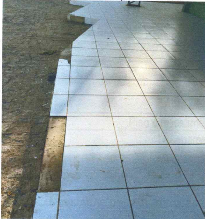
Imagem 10: Deslocamento das placas cerâmicas.
