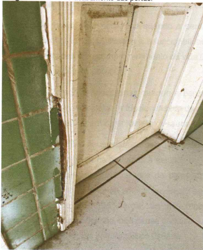
Imagem 9: Falha no acabamento das portas.
